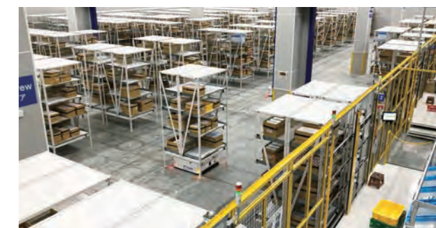
①棚搬送ロボット「Racrew」を活用したピッキング
