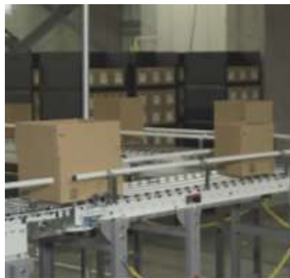
自動搬送コンベア
