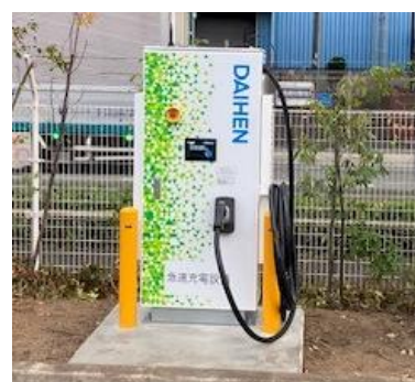
充電ステーション
